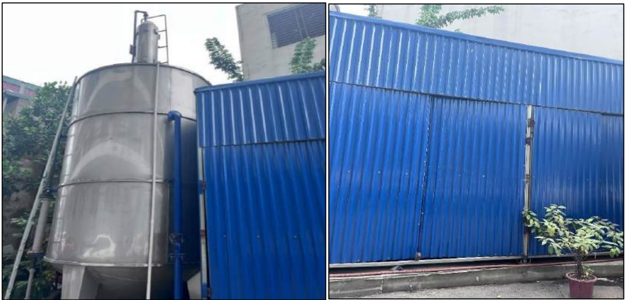
Hình 1. 4. Hệ thống lọc nước của bệnh viện công suất 350\text{m}^3/\text{ngày} đêm
