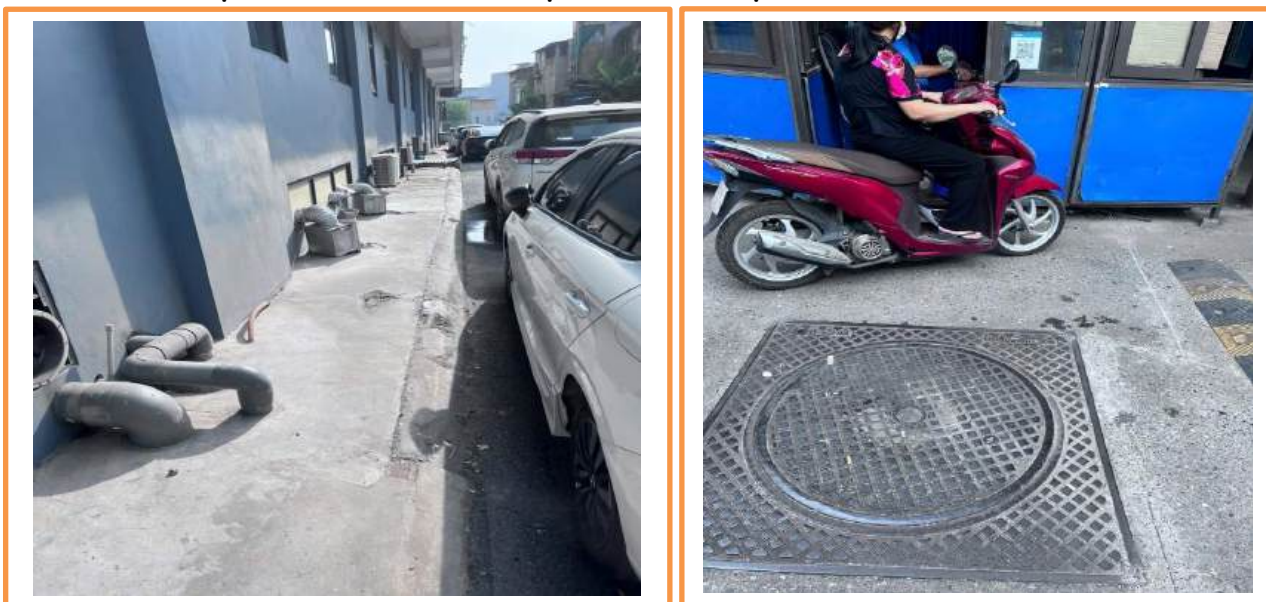
Hình 3. 2. Cống thoát nước mưa và vị trí cửa xả nước mưa số 2
